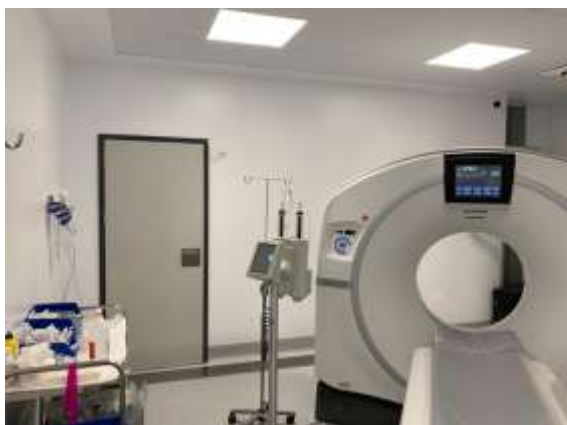
Interior sala de TAC
