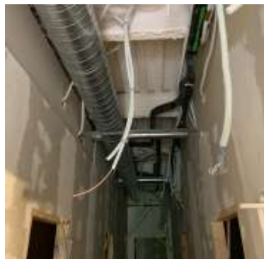
Instalaciones de extracción aire
